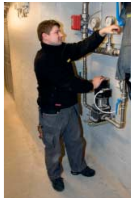
Sprinklercentral til trap- perumssprinkling
